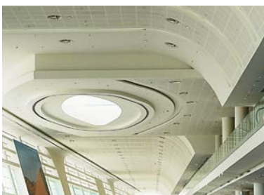
Reizvolle, dekorative Decke aus vorgefertigten Spezial-Gipsplatten.
