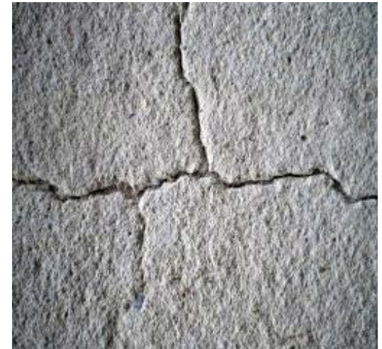
Ettringitbildung unter dem Verputz
